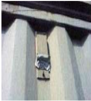
Feritoia di ventilazione otturata
